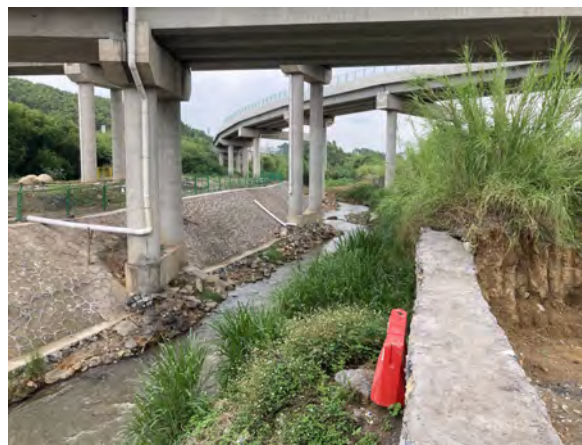
跨梅花河桥梁径流收集管网
