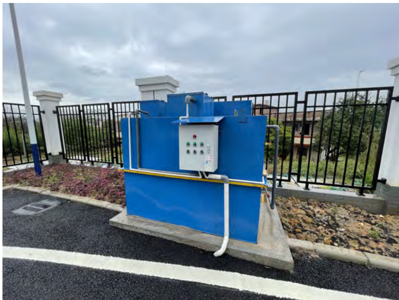
图 9.3-2 收费站污水处理设施
