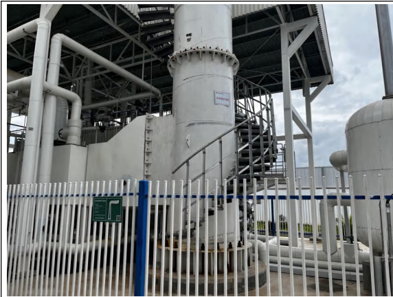
启动锅炉排气筒 DA003
