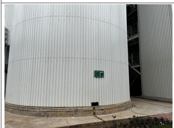
2#余热锅炉排气筒 DA002
