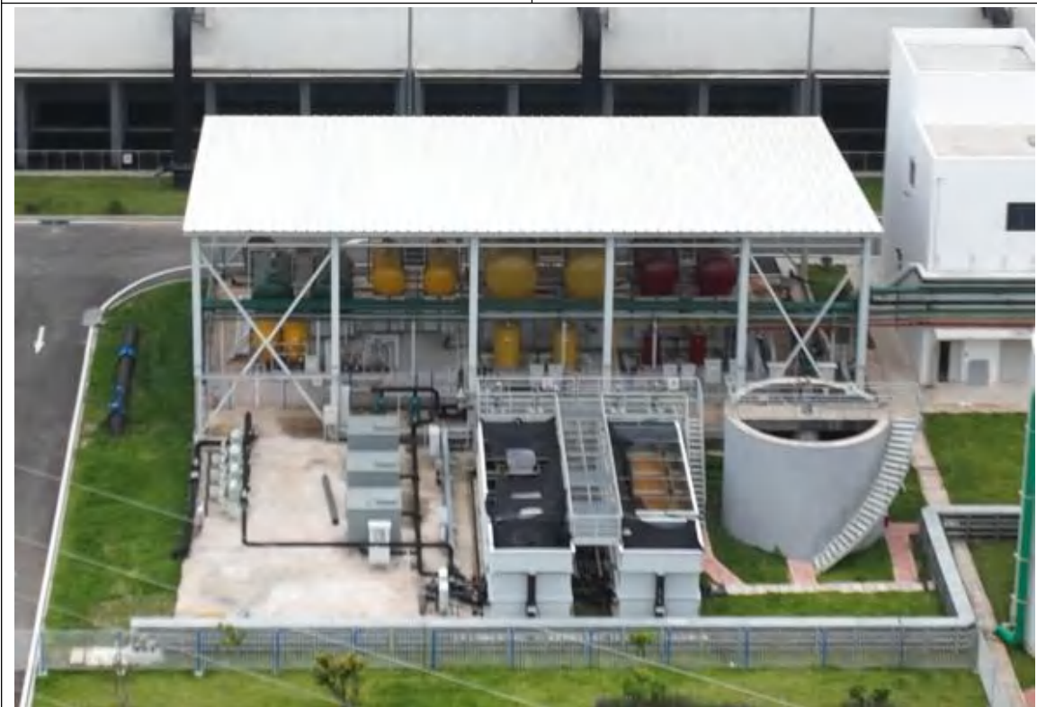
生产废水处理系统
