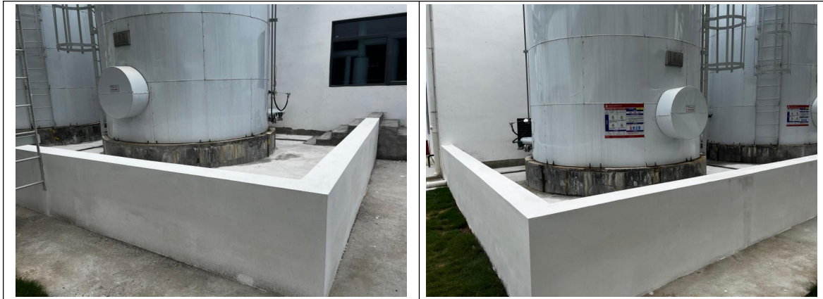
图 4.2-3 尿素溶液储罐风险防范及应急措施
