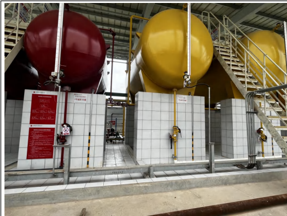
生产废水处理站
