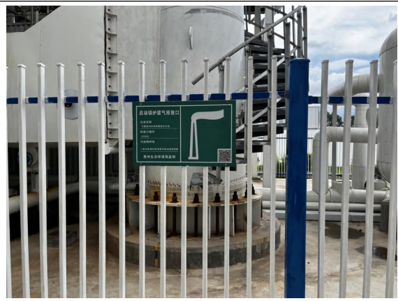
启动锅炉排气筒 DA003
